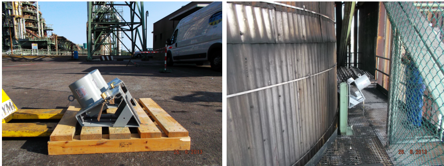
(a) Par de medidores LevelPro necesarios para abarcar la altura de la vasija cámara (b) Medidor LevelPro instalado en la cámara
