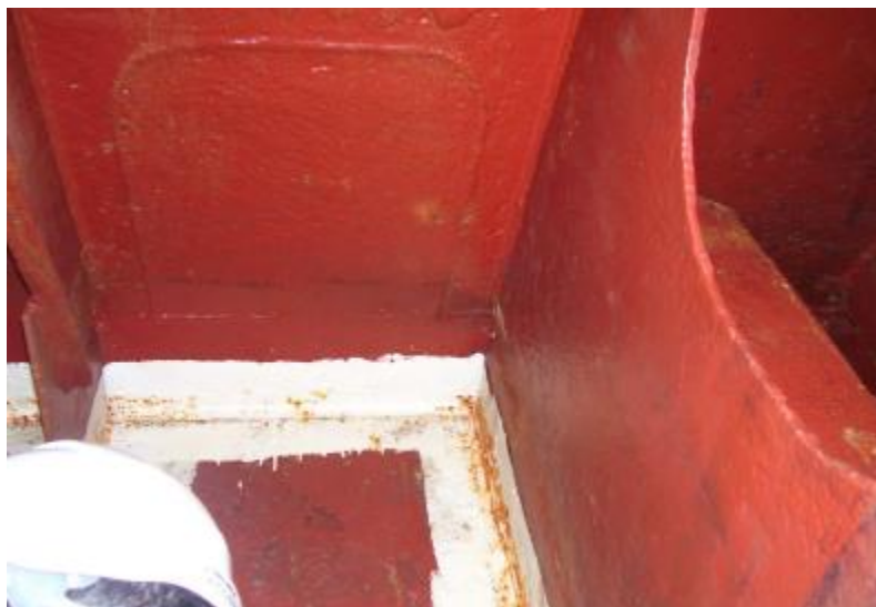
Imagen 5.5. Oxidaciones y falta de adherencias en zonas con repintados incompatibles.
