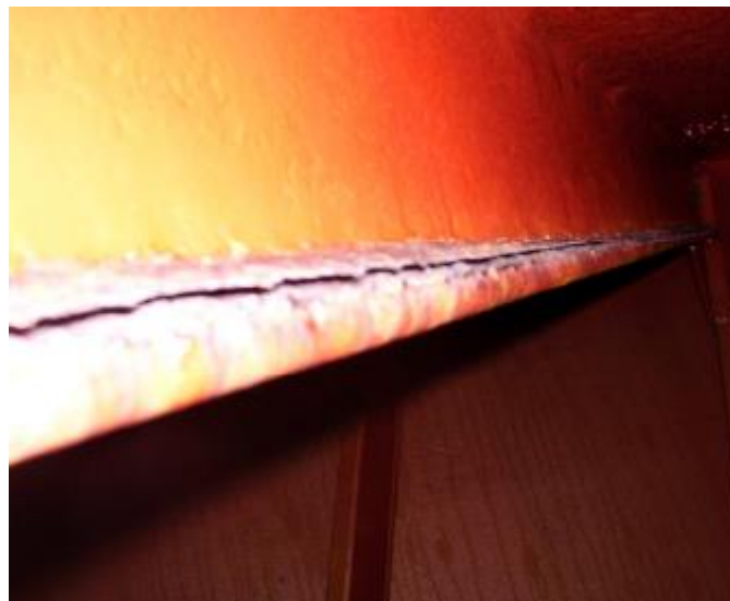
Imagen 5.2. Pique de proa exfoliaciones, desprendimientos y oxidaciones en zona de refuerzos.
