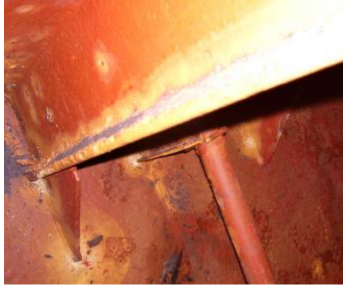
Imagen 5.3. Pique de proa exfoliaciones, desprendimientos y oxidaciones en zona de refuerzos.
