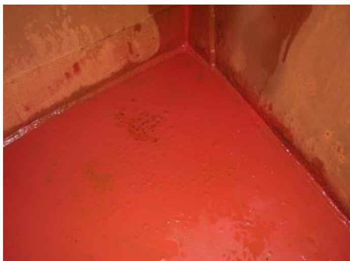
Imagen 5.13. Estado del tanque n o 2 profundo estribor.
