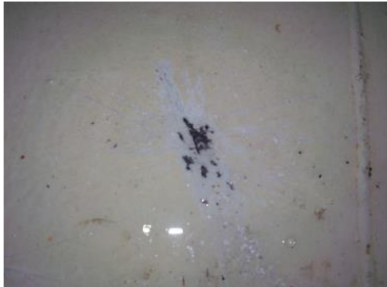
Imagen 5.14. Imagen del estado del interior del tanque nº 13 babor.
