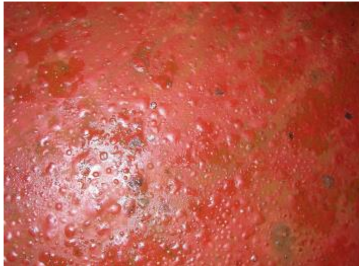
Imagen 5.17. Estado del suelo del tanque nº 2 profundo babor.
