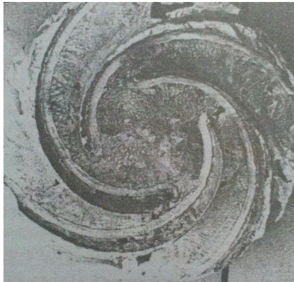
Figura 4.32. Ataque por corrosión-cavitación observado en una bomba de acero inoxidable austenítico. Fuente: Metals Handbook , vol. 13.
