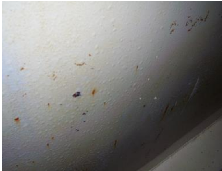
Imagen 5.15. Estado interior del tanque nº13 estribor.
