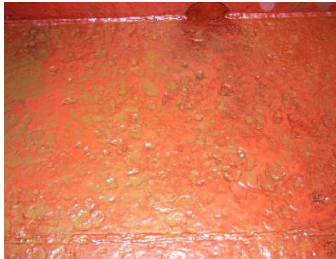
Imagen 5.7. Imagen del tanque en dónde se observa una corrosión generalizada.
