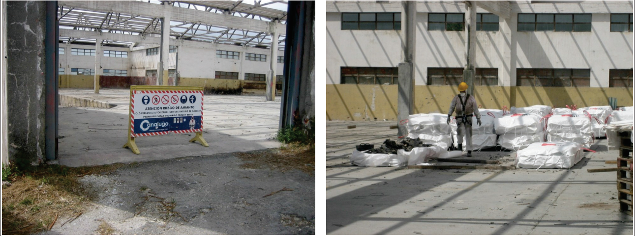
Ilustración 2: Señalización de trabajos de retirada de amianto y restos de amianto preparados para su recogida en una antigua nave industrial.
