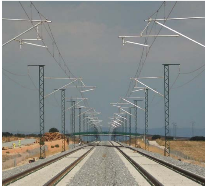
Figura 1.6.1 – Línea aérea de contacto Alta Velocidad
