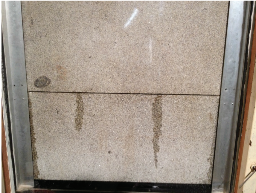
Figura 4.2-1. Fase 1: aparición de agua infiltrada.
