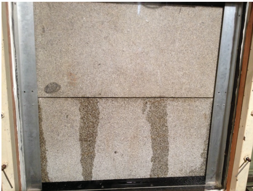
Figura 4.2-2. Fase 2: aumento de infiltración de agua.
