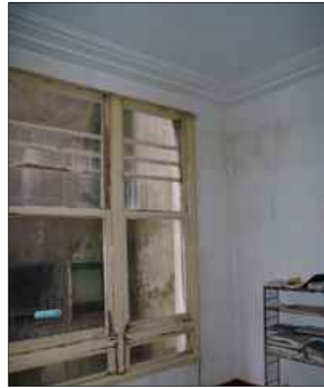
img43_Fachada patio con humedad
