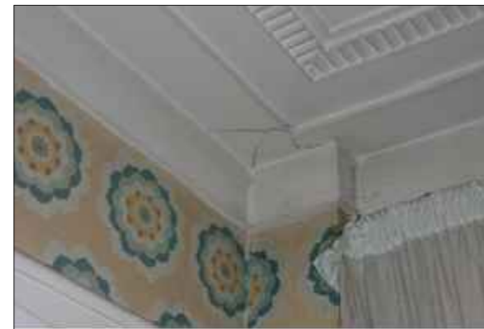
img47_P8 con grietas
