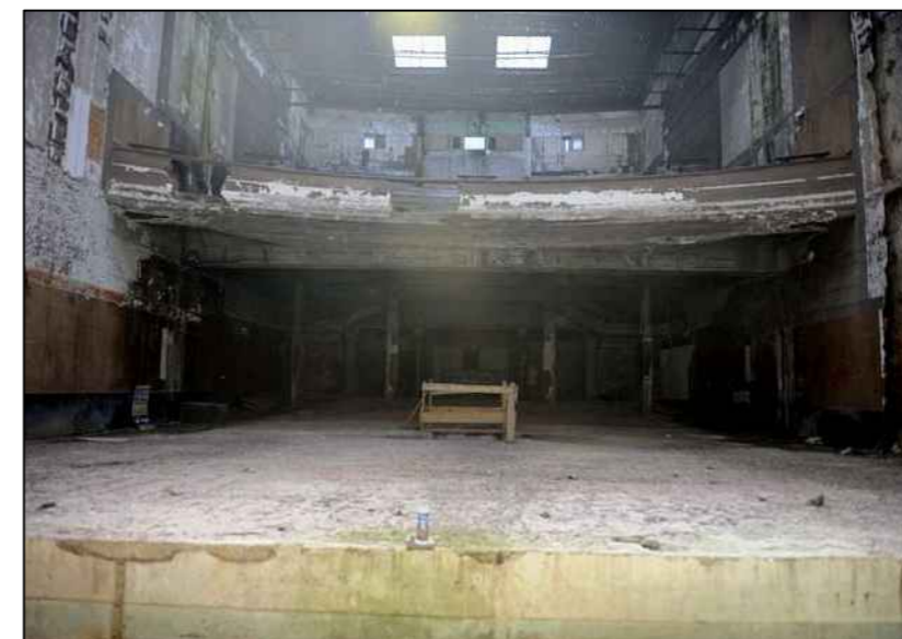
img36_Interior del cine posterior al incendio [ref.14]
