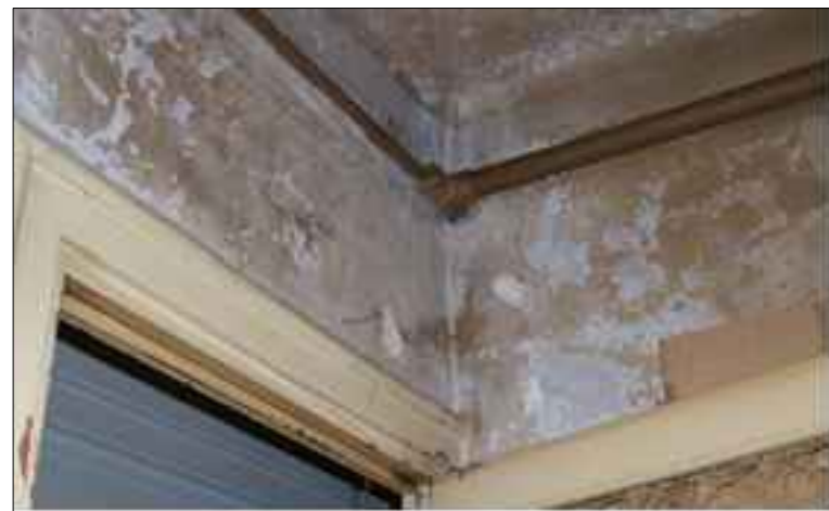
img46_Viga P8-P9 grieta cerca
