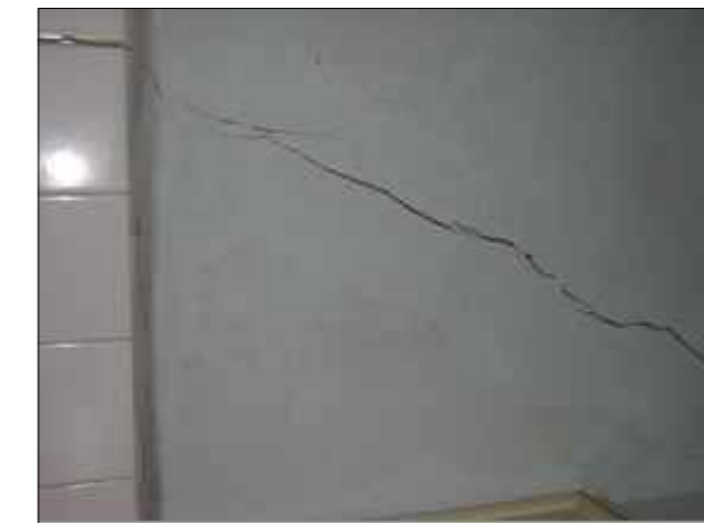
img48_P6 con grietas cerca
