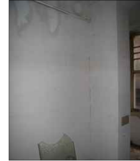
img41_P10 con grieta
