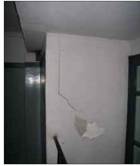
img44/img45_Descansillo escalera agrietado
