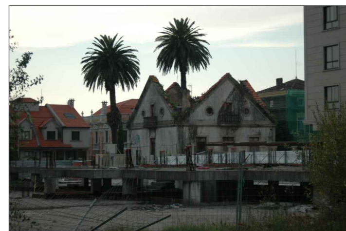
Encuentro fachada sur con este. Se aprecia el inicio de un nuevo edificio residencial.
