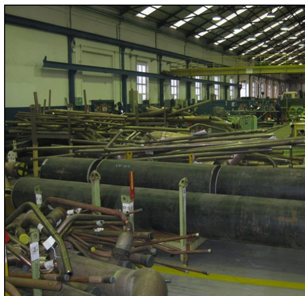
Ilustración 70. Área de almacenaje de tubos a la espera de ser transportados para su montaje
