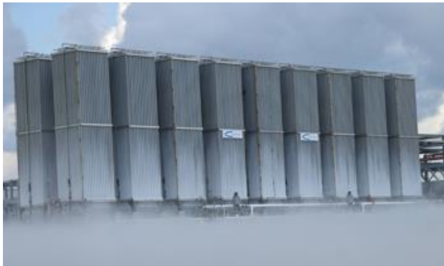
Figura 9: Vaporizadores de GNL atmosféricos [ http://cryoquip.com/lng-systems/lng-vaporizer/ ]
