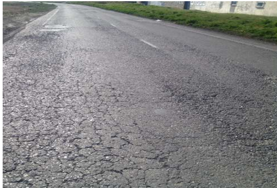
Detalle estado del pavimento
