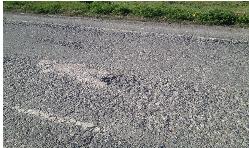
Detalle estado del pavimento
