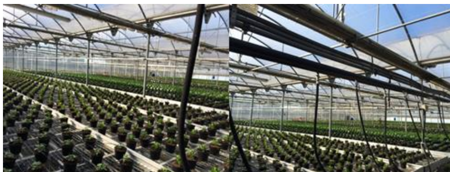
Figura 24. Instalaciones del invernadero caliente
