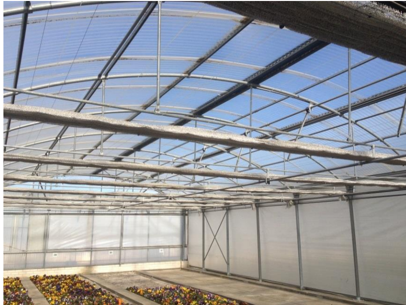
Figura 76. Vista superior de los invernaderos y pantallas de sombreo
