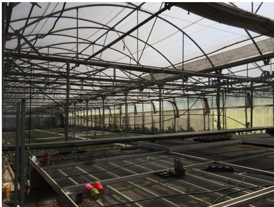
Figura 41. Instalaciones del invernadero caliente
