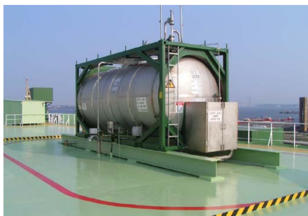
Figura 5.10.- Tanque de metanol instalado en cubierta exterior (Fort, 2011).
