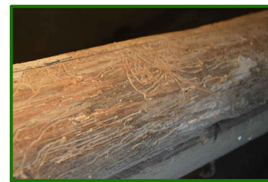
V6_DETALLE DE UNA DE LAS VIGAS AFECTADAS POR CARCOMA EN LA CUBIERTA.
