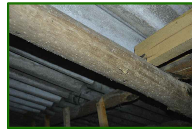
V2_DETALLE DE UNA DE LAS VIGAS AFECTADAS POR POLILLAS
