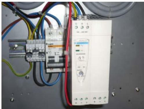
Figura 2.3.9.1 - Fuente de alimentación ABL8REM24050 y magnetotérmico
