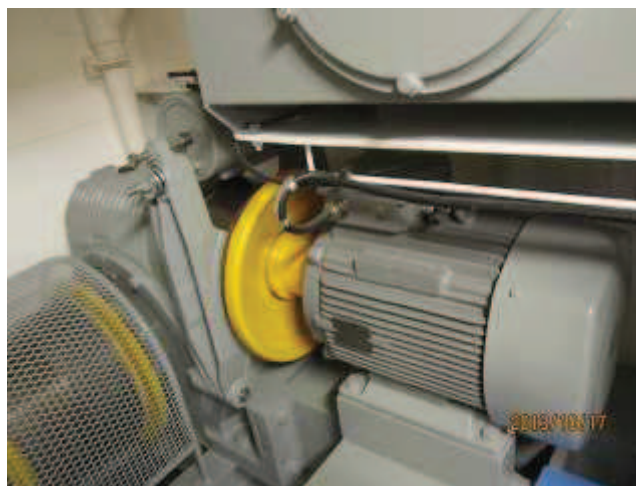
Figura 3.1.2.1.2.1-Motor Dahlander del Montacargas
