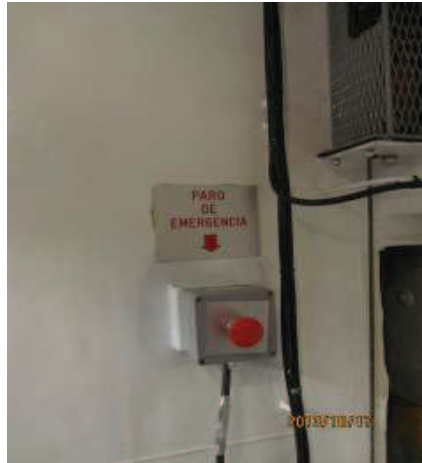
Figura 3.1.2.1.5.2-Pulsador “paro de emergencia” en sala de máquinas
