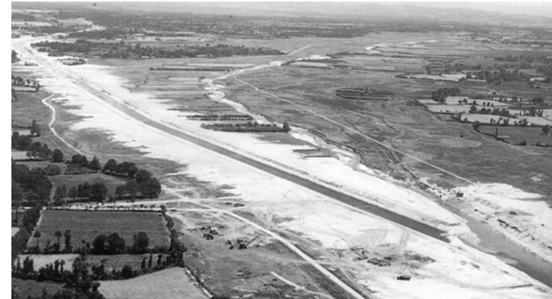
Figura 2: obras de construcción de la red de drenaje de la laguna de Antela.
