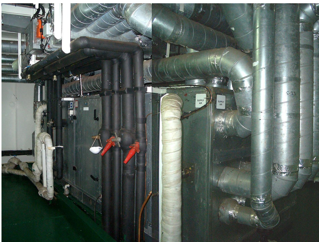
Figura 3.1.2- UTA, zona de impulsión.
