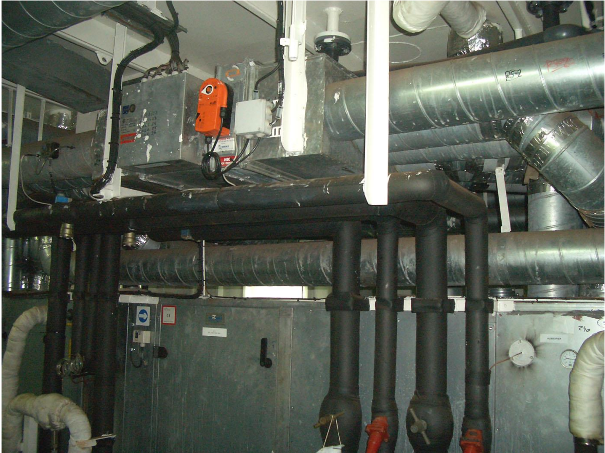
Figura 3.1.3 - UTA con entradas de vapor a baterías.
