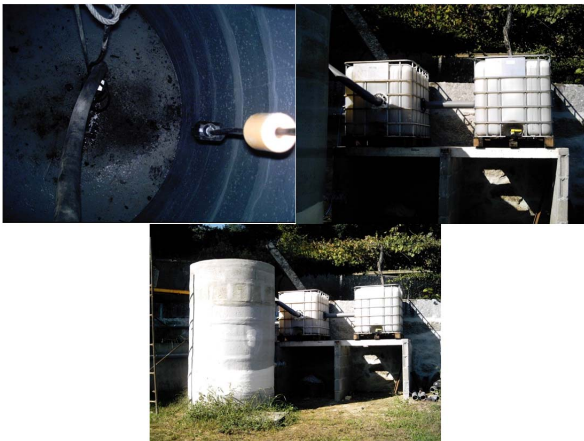
Foto 8-1: Detalle de las fosas de almacenamiento, del digestor HUSB (parcialmente soterrado), de los depósitos de decantación D1 y D2 y de los depósitos de decantación y carga al FV (D1 e D2).
