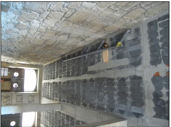
FOTO 1 – ESTRUCTURA; PILARES HORMIGÓN, FORJADO UNIDIRECCIONAL DE SEMIVIGUETAS EN CELOSÍA, BOVEDILLAS DE HORMIGÓN Y MUROS DE PIEDRA.
