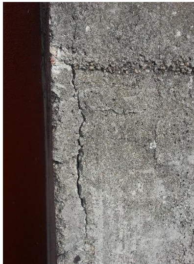
Ilustración 3.3. Fisuración producida por la corrosión de la armadura
