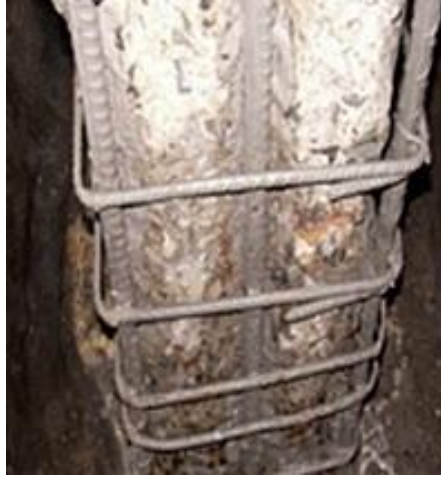
Ilustración 3.10. Armadura al descubierto.
