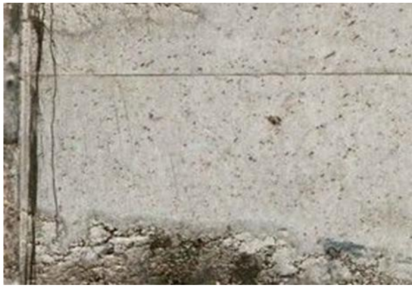
Ilustración 3.1. Daños de abrasión-cavitación.
