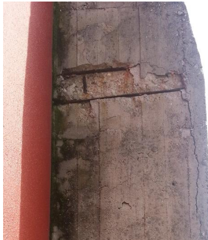
Ilustración 3.2. Delaminación superficial producida por la corrosión de la armadura.
