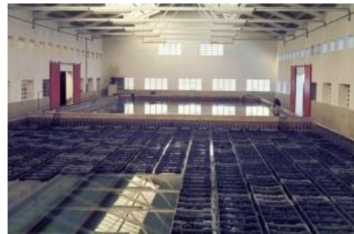
Imagen 2-21: Planta de depuración (56)
