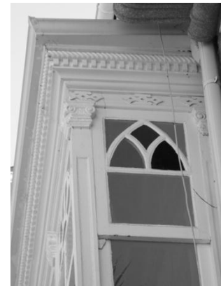
32_Molduras geométricas formando la cornisa de una galería de la rúa do Castro.
