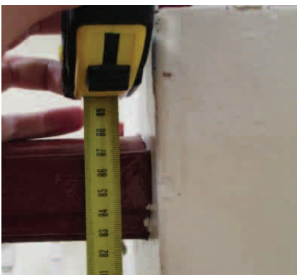
Fig. 404. Altura de barandilla (fuente propia)
