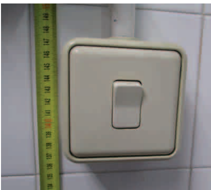
Fig. 425. Interruptor a altura excesiva y sin contrastar cromáticamente con el alicatado (fuente propia)
