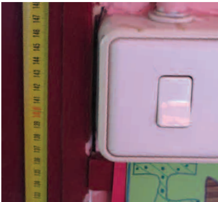
Fig. 422. Interruptor a 1,43m de altura (fuente propia)
