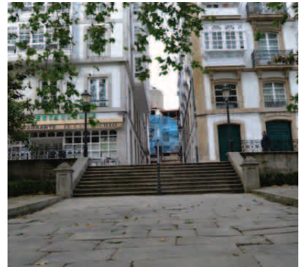
Fig. 344. Defectos en el enlosado (fuente propia)
