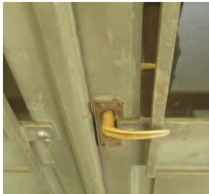
Fig. 423. Accionamiento de la puerta del patio de recreo (fuente propia)
