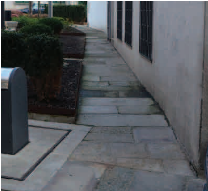
Fig. 264. Ancho libre de paso insuficiente (fuente propia)
