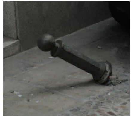
Fig. 260. Bolardo en mal estado (fuente propia)
