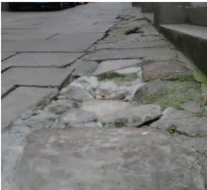
Fig. 246. Huecos, resaltes y piezas sueltas (fuente propia)
