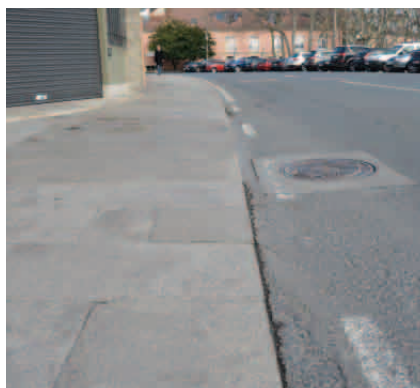
Fig. 304. Ausencia de vado peatonal accesible (fuente propia)
