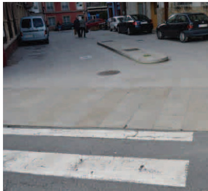
Fig. 301. Ausencia de vado peatonal accesible (fuente propia)
