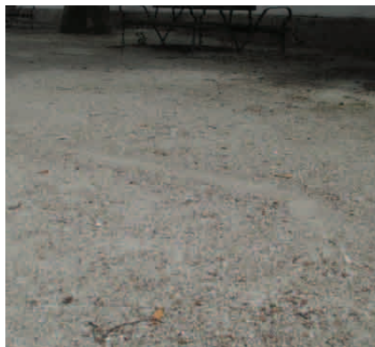
Fig. 325. Grava suelta (fuente propia)
