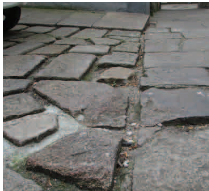
Fig. 247. Huecos en juntas de hasta 12cm (fuente propia)
