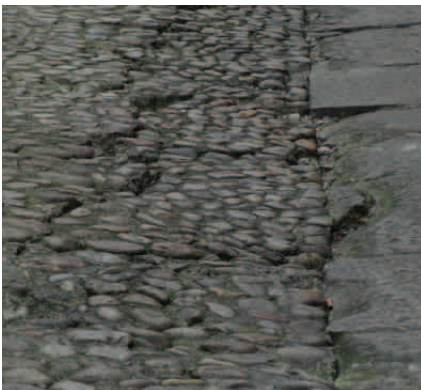
Fig. 258. Huecos, resaltes y piezas sueltas (fuente propia)
