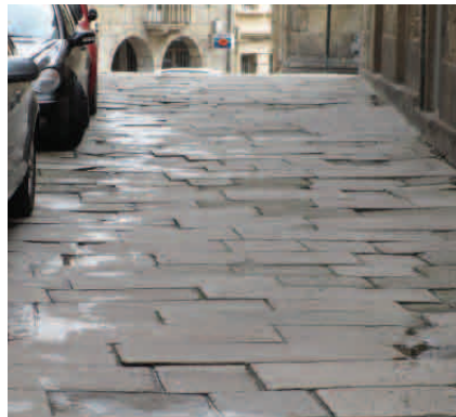
Fig. 199. Enlosado en mal estado (fuente propia)
