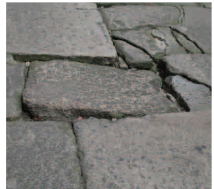
Fig. 242. Piezas sueltas y huecos (fuente propia)
