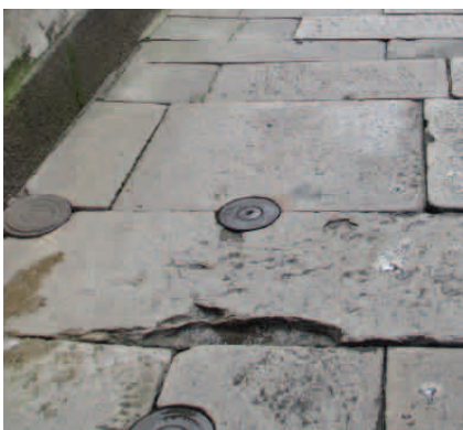
Fig. 174. Defecto en el enlosado (fuente propia)
