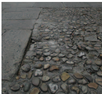
Fig. 208. Huecos, resaltes y piezas sueltas (fuente propia)
