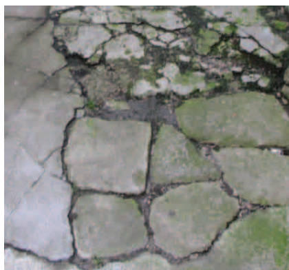
Fig. 214. Pavimento en mal estado (fuente propia)
