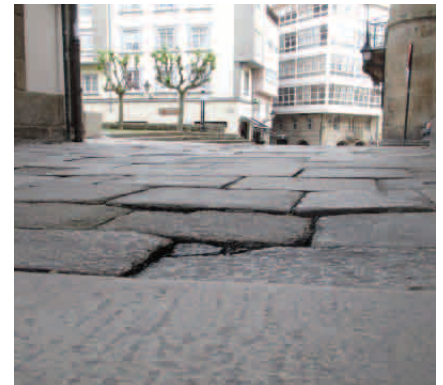
Fig. 200. Enlosado en mal estado (fuente propia)
