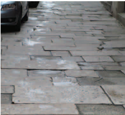
Fig. 198. Enlosado en mal estado (fuente propia)
