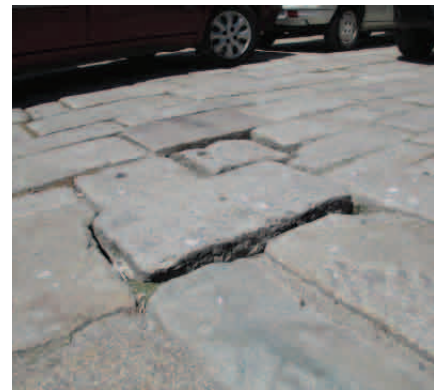
Fig. 104. Huecos, resaltes y piezas sueltas (fuente propia)
