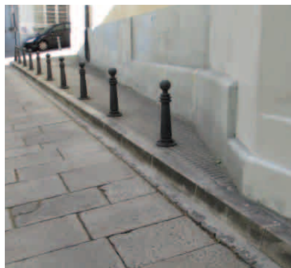
Fig. 151. Ancho acera insuficiente y desnivel (fuente propia)
