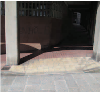
Fig. 126. Acera y vado peatonal tipo A en encuentro con c/Santiago (fuente propia)
