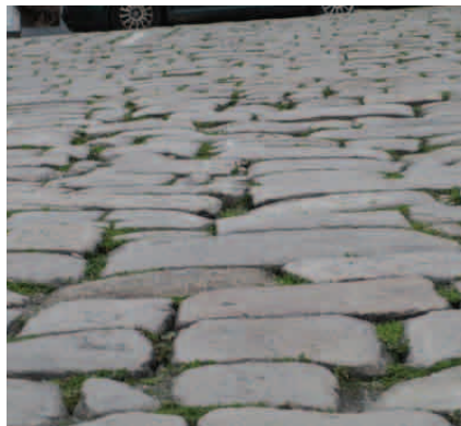
Fig. 103. Huecos, resaltes y piezas sueltas (fuente propia)
