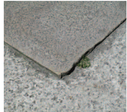
Fig. 128. Resalte en cambio de pavimento (fuente propia)
