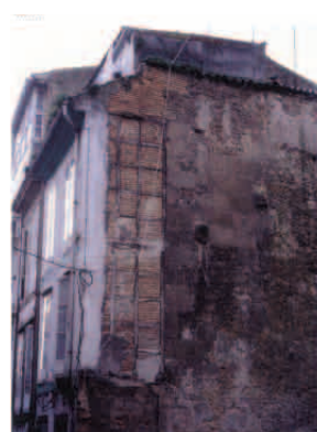
Fig. 8. Ejemplo de eliminación de soportales y adelantamiento de la fachada (fuente: Arquitectura da provincia da Coruña )
