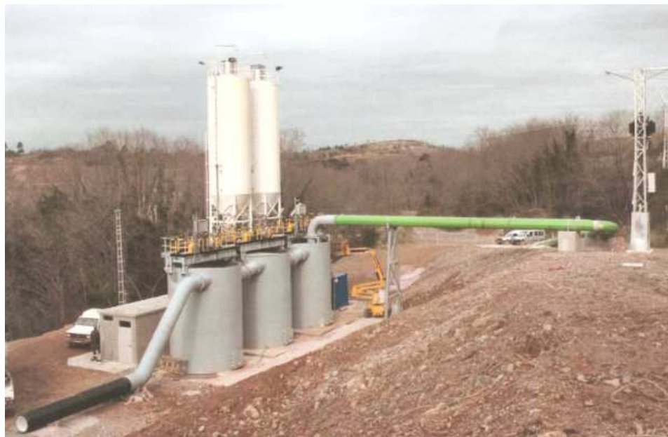
Figura 50. Planta depuradora utilizada para tratar el agua de mina de Reocín antes de su vertido al río Besaya (Alonso y Fernández, 2006).
