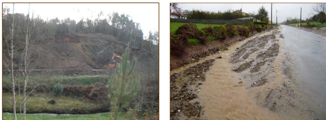
Figura 6.11. Las infraestructuras viarias como fuente de sedimentos a) Trabajos de desmonte. b) Aporte de sedimentos desde un vial próximo al cierre de la cuenca.
