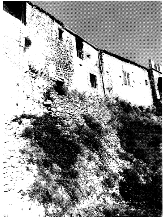
Figura 3 La construcción de las casas-muralla utiliza técnicas y materiales similares a los que caracterizan las murallas del pueblo
