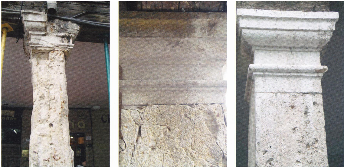
Lesiones en la caliza de páramo microfisurada en las columnas de la plaza de Cervantes en Alcalá de Henares. Izquierda, importantes pérdidas debidas a la cristalización de sales en las fisuras, derivadas del desagüe de la bajante. Centro, detalle de la microfisuración ya algo abierta por las sales. Derecha, columna en caliza de páramo exenta de fisuras. Se aprecian las características coqueras, porosidad móldica de tallos de algas.
