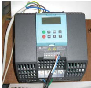
Figura 3.11. Ventilador y sistema de control de velocidad.
