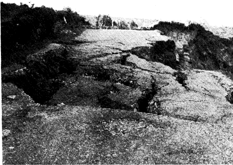
Fotos 1 y 2. Aspectos de la destrucción de la carretera del Faro y frente acantilado, como consecuencia de procesos naturales en la evolución de costas.
