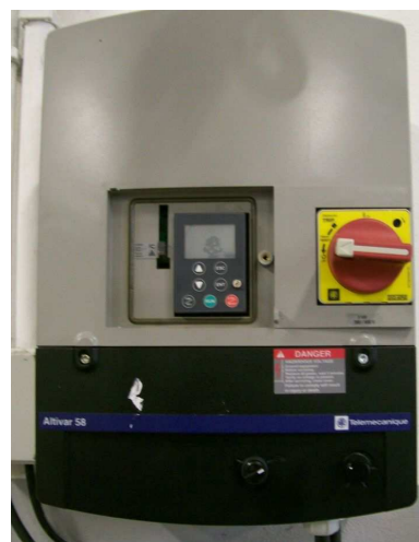
Fig. 91 Variador de frecuencia
