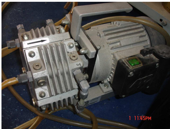
Fig. 104 Bomba de vacío
