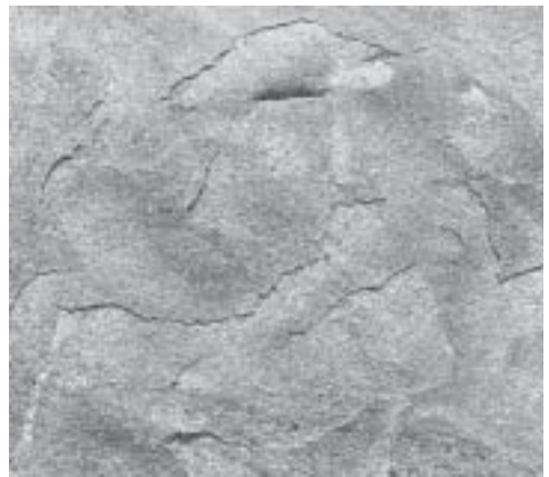
Fig. 3. Descamación por alteración en granitos (Coruña, España).
