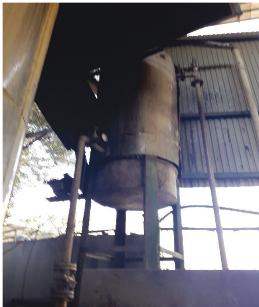
Figura 2.14. Tanque de desorción
