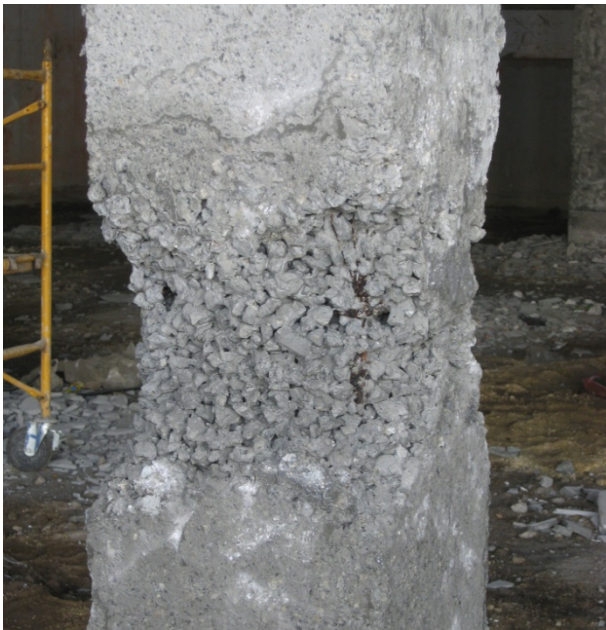
7. Detalle de un pilar con pérdida de áridos y de sección, coqueas y segregación
