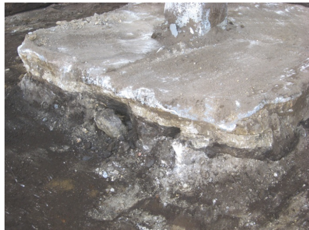
8. Estado previo de las zapatas aisladas.
