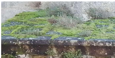
Humedad- Suciedad vegetal.
