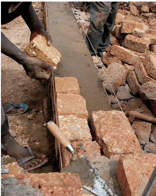
Fig 5.02 Construcción de muro doble de bloque de piedra laterita. Escuela secundaria en Dano. Fotografía de Kéré Architecture.
