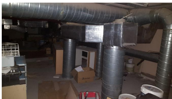
Imagen 15. Cuarto de instalaciones
