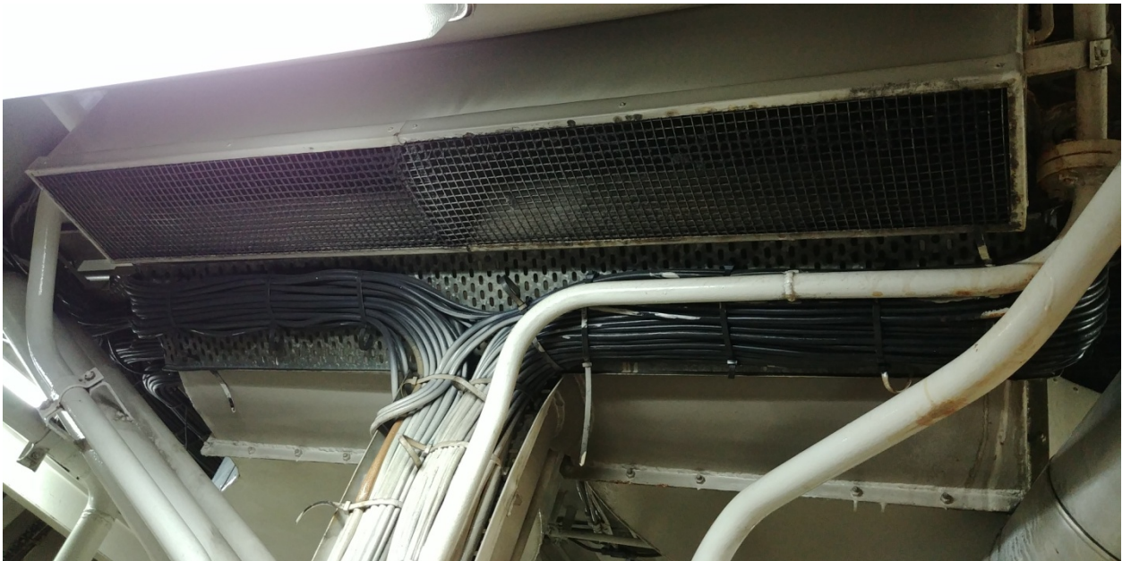
Figura 2.3.8.2- Ventilación central sala de máquinas. (Original del autor)
