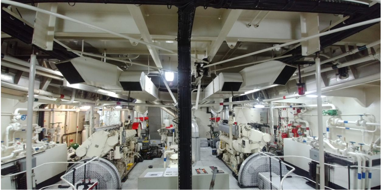
Figura 2.3.8.4- Ventilación de la proa de la sala de máquinas. (Original del autor)
