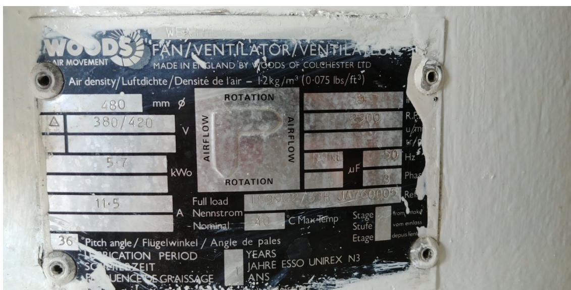
Figura 2.3.9.2.1- Placa de características motor trifásico ventilación babor. (Original del autor)
