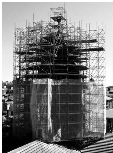
Fig. 19. Espectacular andamio para la restauración exterior del cimborrio entre 2016-2018. (Archivo R. Yzquierdo).
