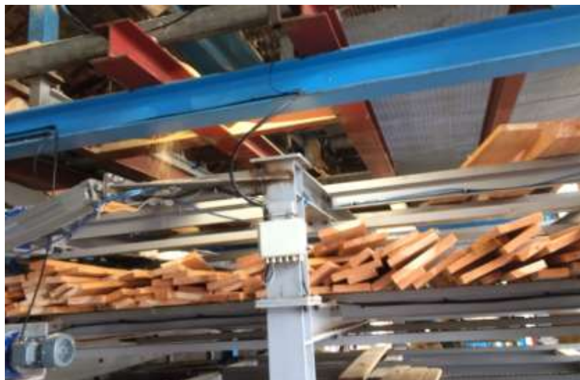
Figura 40: Buzón donde se almacena la tabla de 2 metros hasta su posterior secado y apilado. (Fuente: Elaboración propia)
