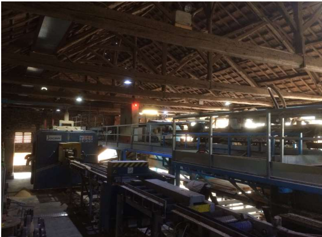
Figura 90: Luz roja que indica una señal de alarma debido a un atasco en el sistema. (Fuente: Elaboración propia)
