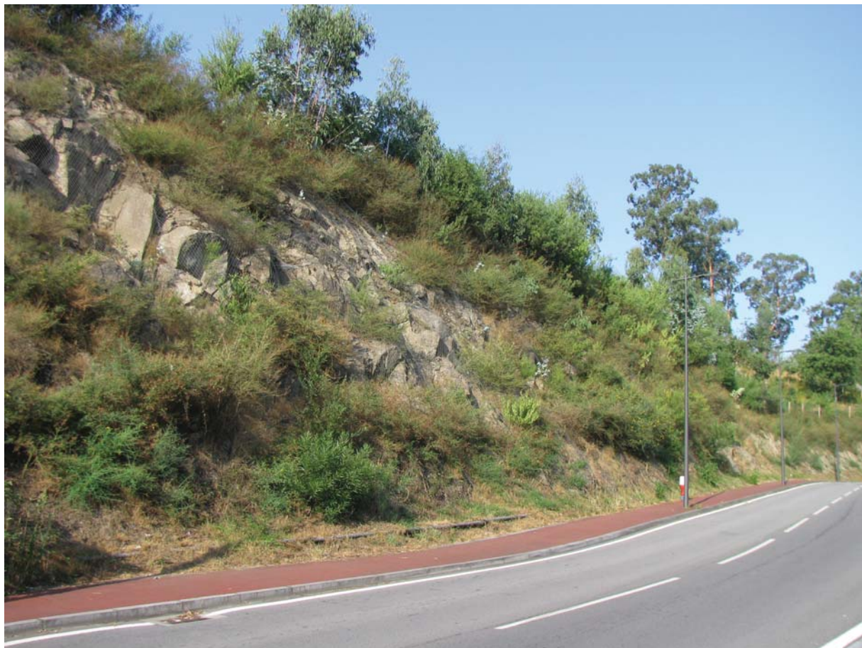
Fig. 3. Redes de contenção para estabilização de talude. Reparar ainda no extenso desenvolvimento da vegetação neste talude com menos de uma década de exposição.
