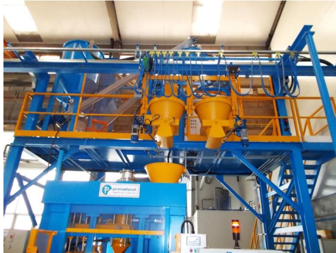
Imagen 9.10: Tolva por la que se produce el vaciado a la disparadora.
