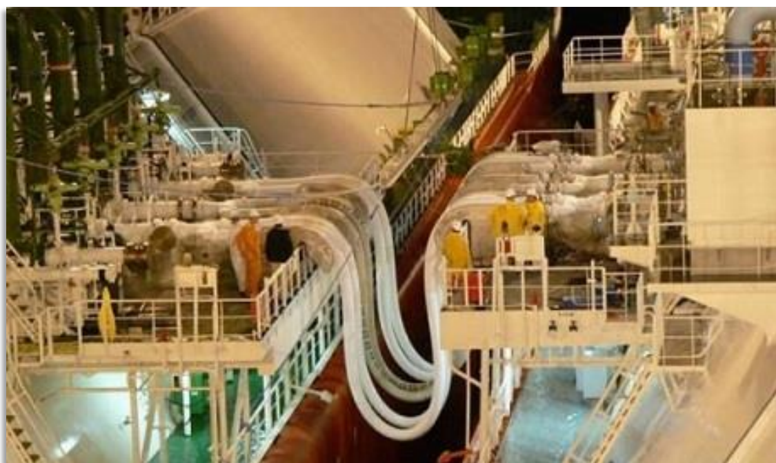
Imagen 66: Mangueras criogénicas durante la operación de transferencia
