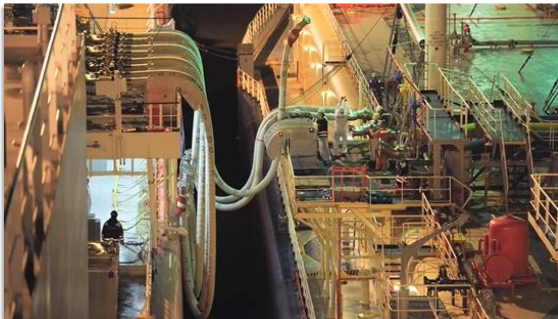
Imagen 64: Acople de mangueras apoyadas en la silla al manifold.
