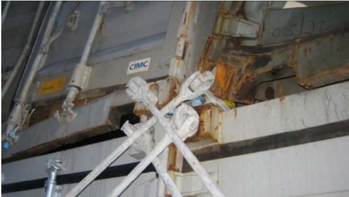
Figura 2.10 Estado de los elementos de trincado en el Svendborg Maersk [21]
