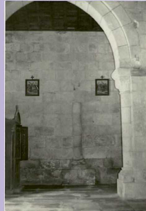
77.- Desajuste entre los pilares centrales y las columnas adosadas a los muros, por cambios en el trazado románico (foto JRS-1976)
