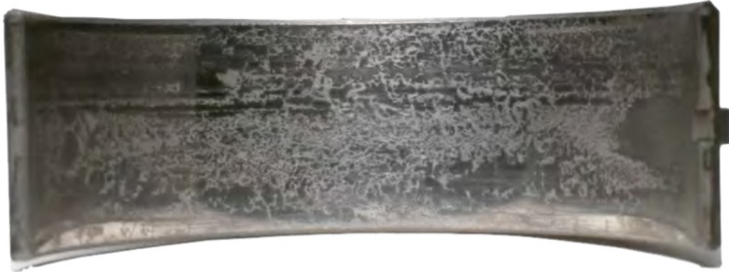
Fig. 11.5.1.1 Deterioro del 75% de la superficie total del revestimiento.
