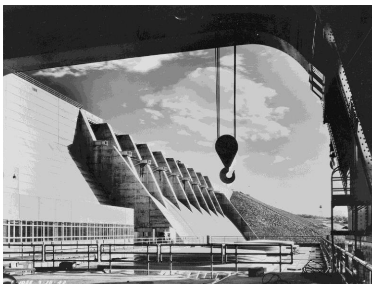
8. La presa Cherokee de la TVA en construcción, Tennessee, h. 1945 (Library of Congress Prints and Photographs Division, LC-USW33- 015646-ZC)
